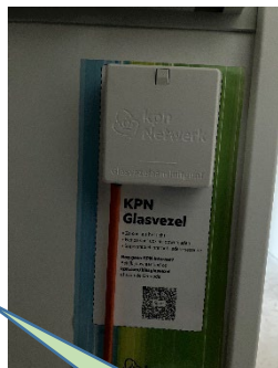
Aansluitingen internet in de meterkast
